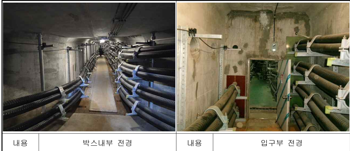
【사진 3.1】 문발SS인출 전력구 현황
